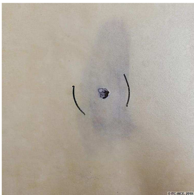
Figura 133. Defectos aparecidos en la probeta ON7-14. Se puede observar los desconchados que aparecen en la
