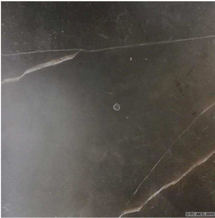
Figura 139. Defectos aparecidos en la probeta R1-15. Se puede observar la fisura circular en la zona de impacto.
