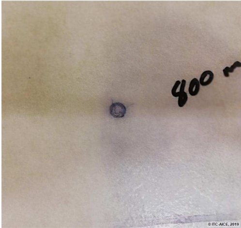
Figura 136. Detalle de las fisuras circular y radiales de la probeta ON7-15
